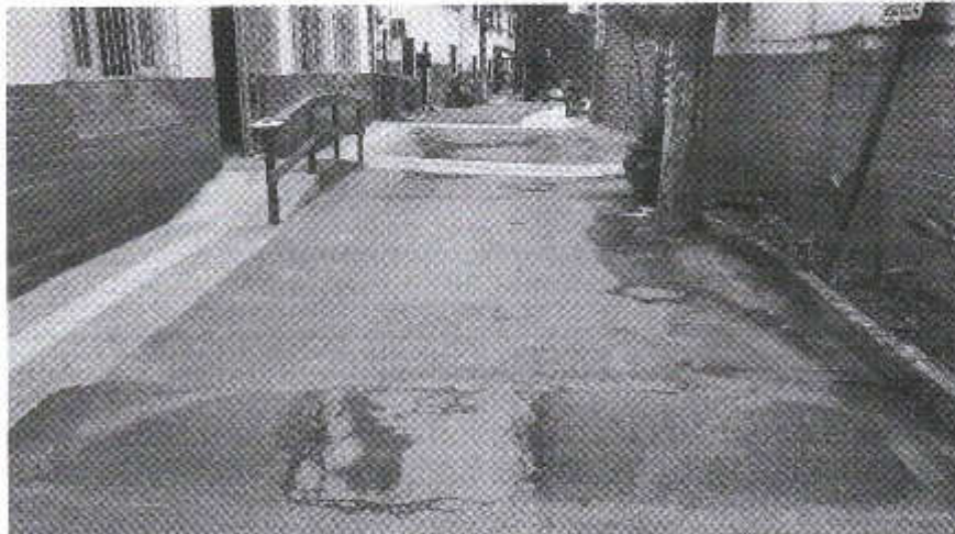
Nesta VISADA, local do quebra-molas existente – observar em planta a execução de outro quebra-molas, pisos e jardineiras.
