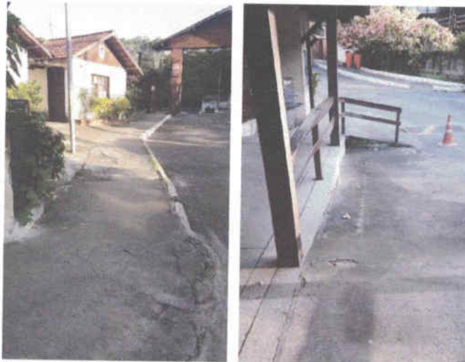
Fotos 1 e 2 - A esquerda, calçada existente, à direita trecho para ser executada calçada, alinhando pela construção.
