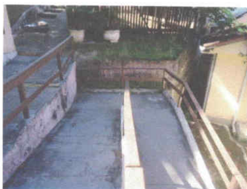
Foto 37 – esta rampa com patamares chega até a porta de acesso do bloco 5, em seu 1º pavimento.
