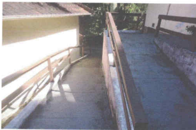
Foto 36 – início da rampa na extremidade do bloco 6 (equivalente ao seu pavimento térreo) e subindo até o 1º pavimento do bloco 5.
